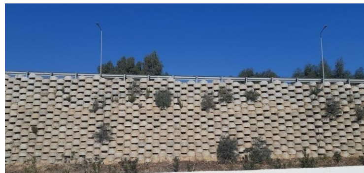
Fig. 2 Développement de la végétalisation au niveau d'un mur en blocs de béton sur l'Autoroute A1, Tunisie
